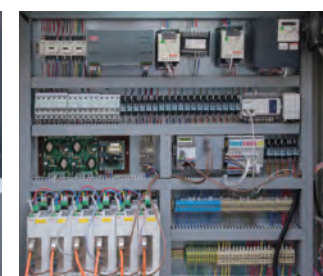
德国著名厂家控制系统 Germany Control System
